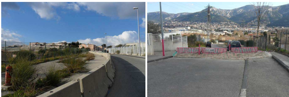
Photo 32-1 Voie des hauts de la Martine partiellement neutralisée (effondrement latéral), 12 ème arr. Photo 32-2 Voie des hauts de la Martine barrée, 12 ème arr.
